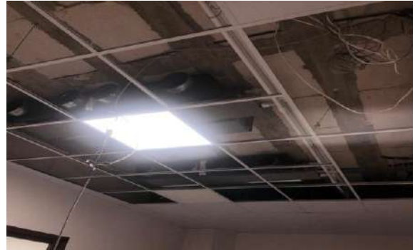
AKM Merkezi Klima Sistemi Yapılması
